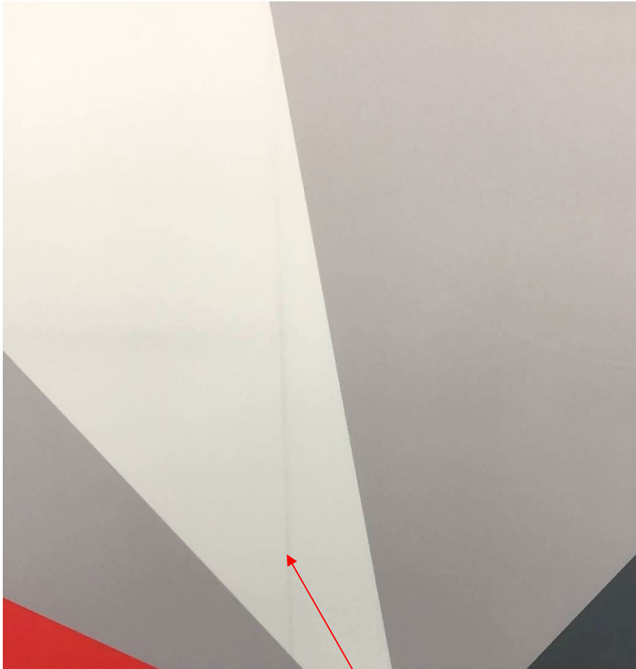
Stoßfuge mangelhaft hergestellt
